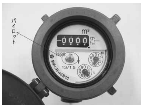
蛇口を閉めた状態で、パイロットが回っている場合は漏水です
