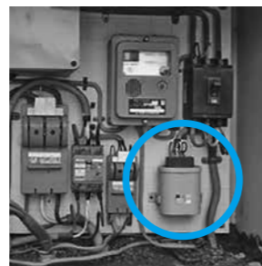
分電盤内の低圧コンデンサー
