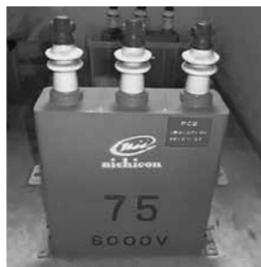
電力用コンデンサー
