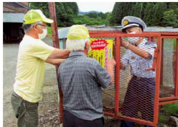
特殊詐欺の注意喚起表示板を設置する関係者
