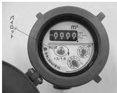
蛇口を閉めた状態で、図内のパイロットが回っている場合は漏水です
